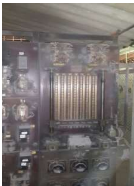
Рисунок 1 – Оборудование станции ТЭЦ ПВС
